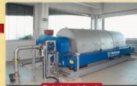
Mechanisch entwässerter Schlamm 20-40 Ma. % TS
